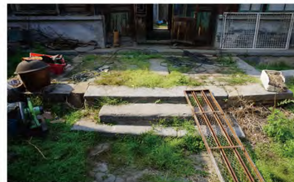
正房建筑地坪抬升
